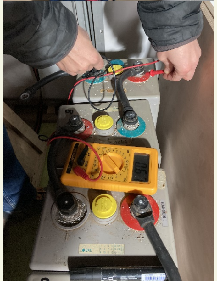
Batteriespannung checken Multimeter
