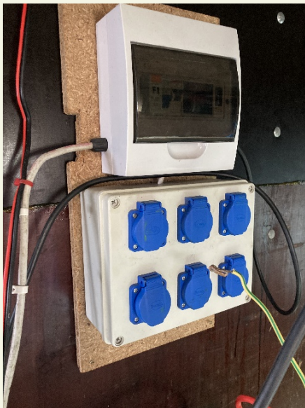
AC Stromkasten und Mehrfachsteckdose Versorgung Camp
